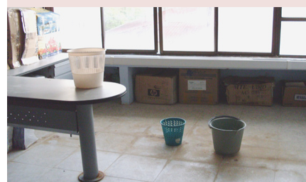
Estado de las instalaciones de la Procuraduría Regional del Chocó, registrado en la visita de verificación realizada por la Oficina de Control Interno de la PGN.
